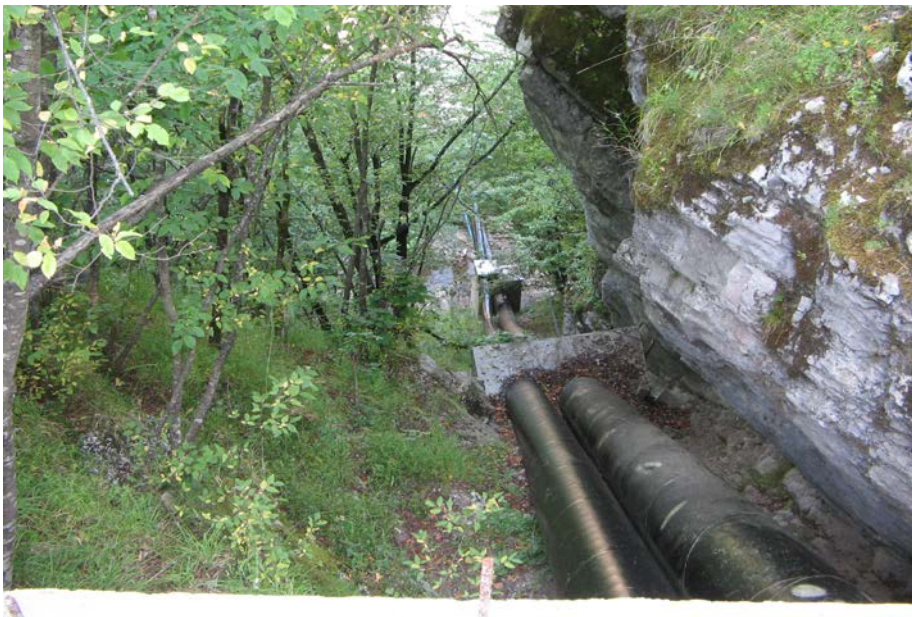
Слика 11. Тлачни цјевовод којим се вода из водозавата транспортује до машинске хале МХЕ остављајући узводно већи дио године дио ријечног корита сухим (види Слику 9)
