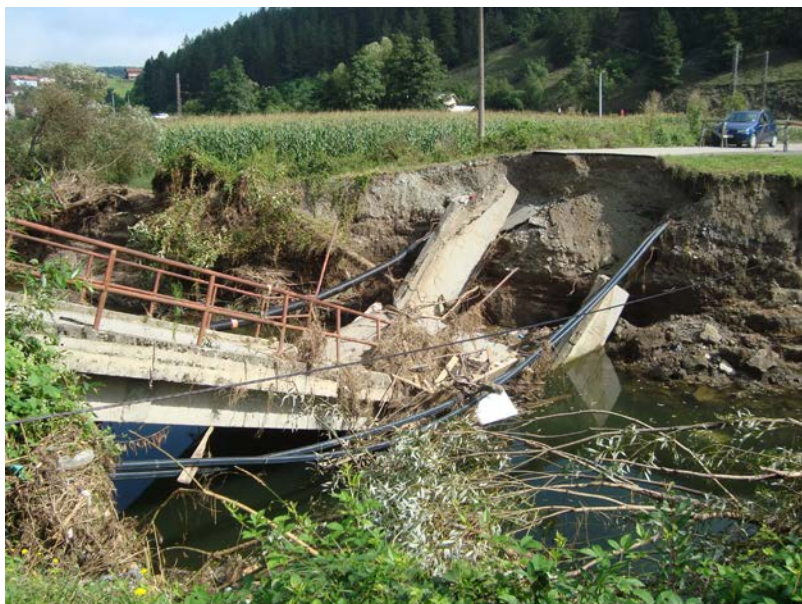
Слика 52. Срушени мост на ријеци Јошавки у насељу Јошавка Доња – поплаве у мају 2014. године (општина Челинац)
