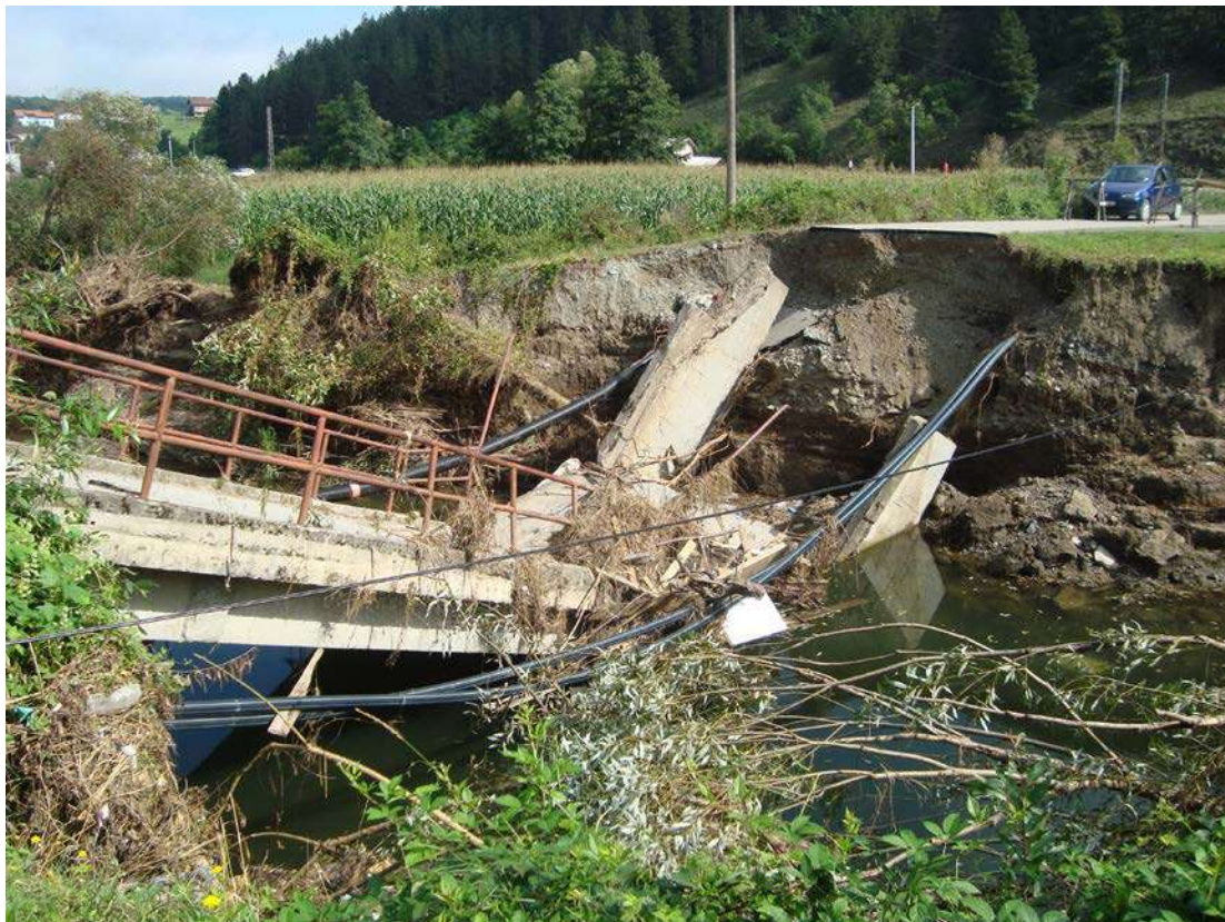
Слика 4. Срушени мост на ријеци Јошавки у насељу Јошавка Доња – поплаве у мају 2014. године (општина Челинац)
