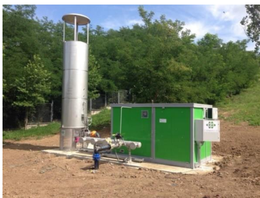
Slika 10.9. Postrojenje za spaljivanje deponijskog gasa (baklja) na sanitarnoj deponiji Ramići kod Banjaluke (DEPOT, 2020)
