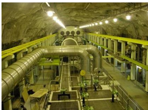
Slika 5.14. Unutrašnji izgled podzemnog kanala i procesnih instalacija u centralnoj podzemnoj stanici u Hong Kongu (ISWA Report, 2013)
